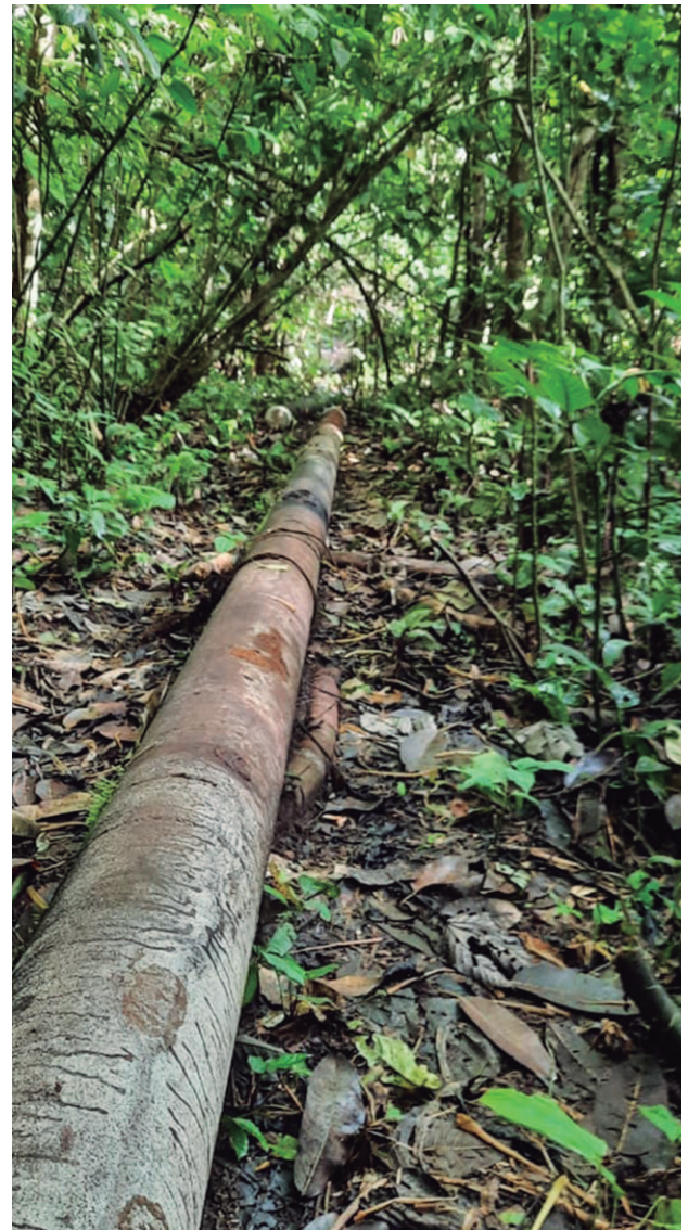
Ductos de petróleo abandonados foto: comunidad de Pucacuro
